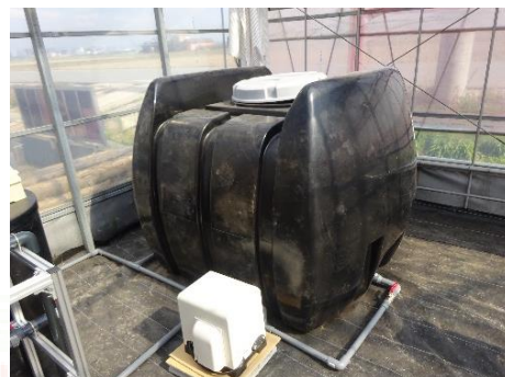
原水タンク（ハウス内に設置）
